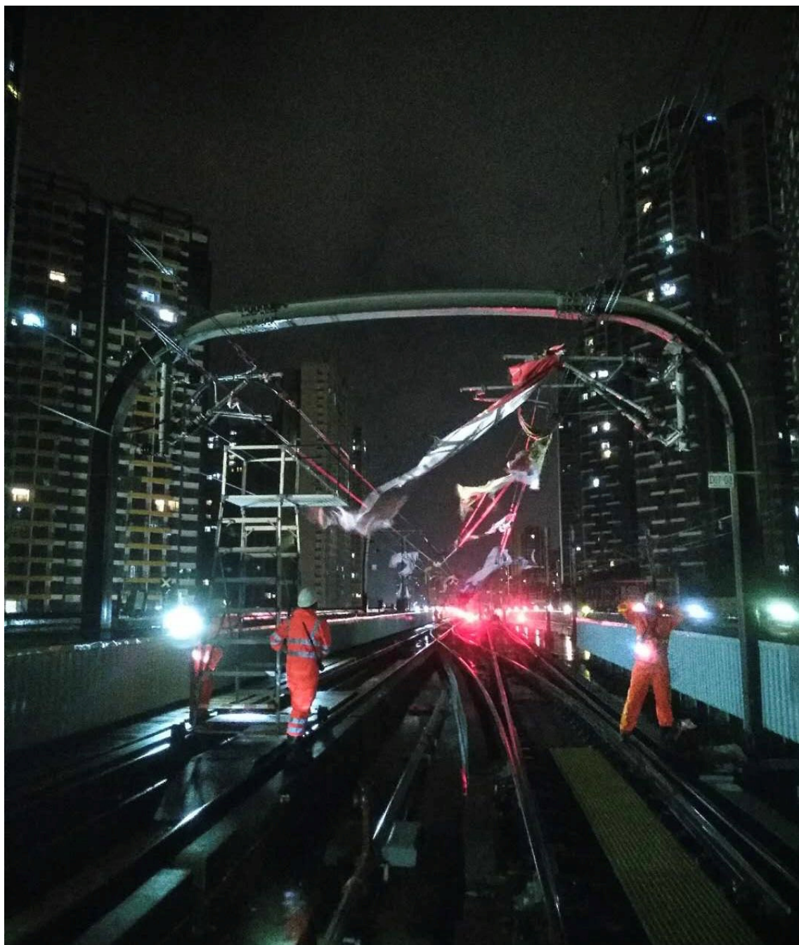
港铁侠清理 4 号线接触网的异物
