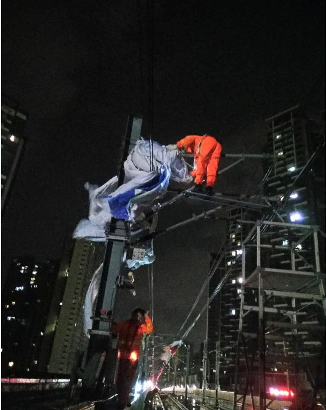
港铁侠清理 4 号线接触网的异物
