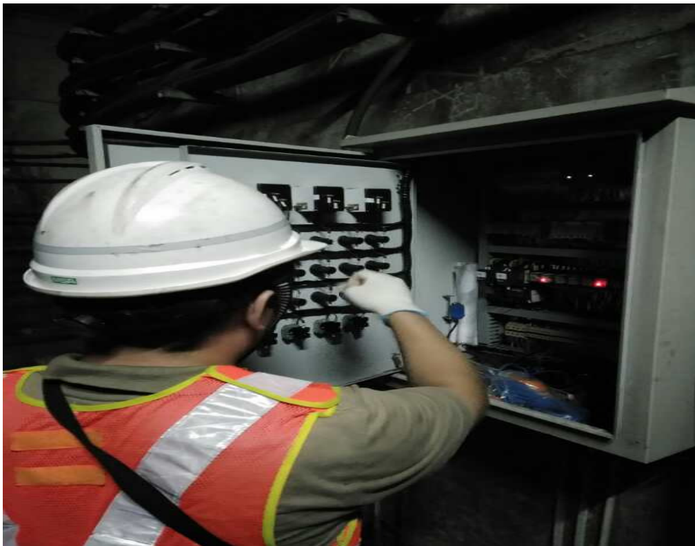
区间电源箱检查紧固
